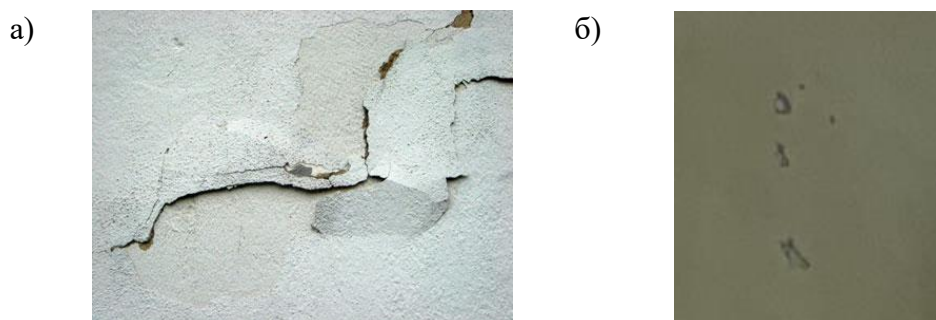
Рисунок 1 – Характерные дефекты штукатурного слоя системы утепления «термошуба»: а – вздутие и разрушение; б – шелушение и отслоение
