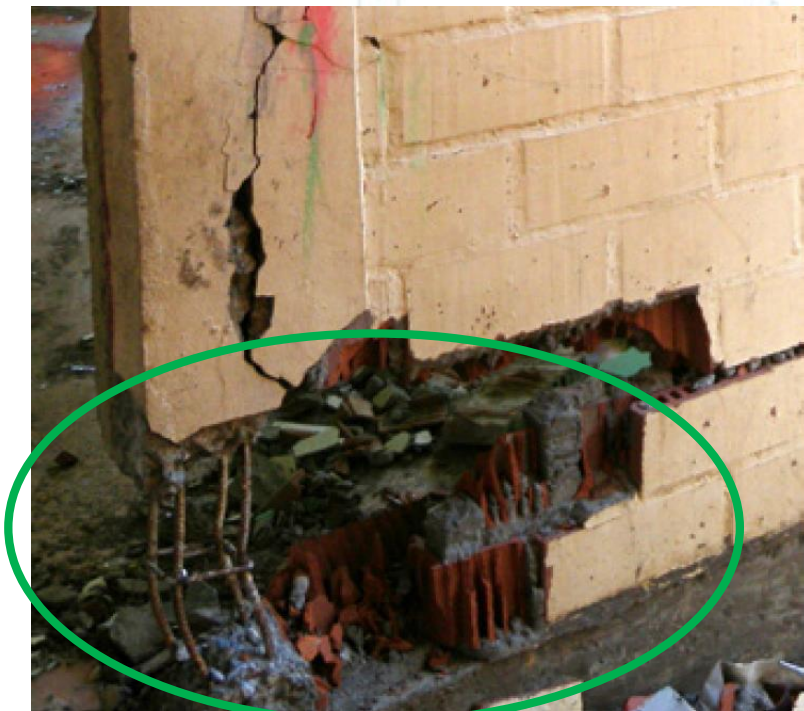
Разрушение здания со стенами комплексной конструкции из-за недостаточного качества кладки и вертикальных железобетонных включений
