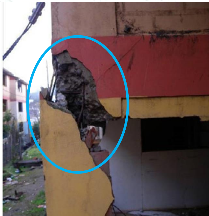
Разрушение здания со стенами комплексной конструкции из-за дефектов поперечного армирования в вертикальных железобетонных включениях
